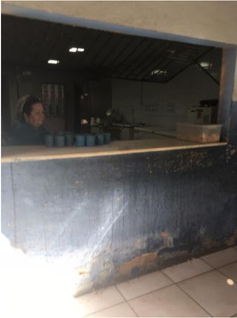
Balcão sem aproximação adequada
