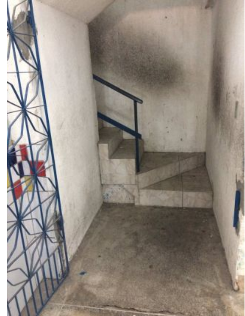
Escada com corrimão inadequado; sem fita antiderrapante, patamar inadequado e ausência de sinalização
